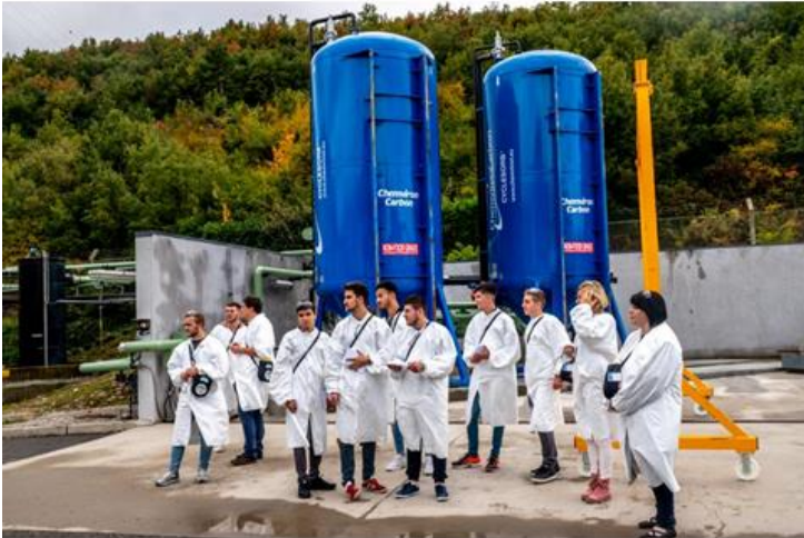
Les deux filtres à charbon actif qui permettent d'achever le traitement de l'eau épurée.
